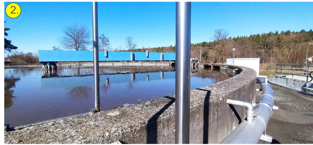
Blick auf Belebungsbecken I
