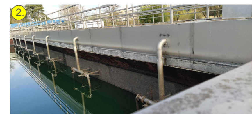
Blick auf Belebungsbecken II - Belüfterleitungen
